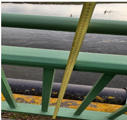
Photo N° 5 : hauteur de garde-corps
