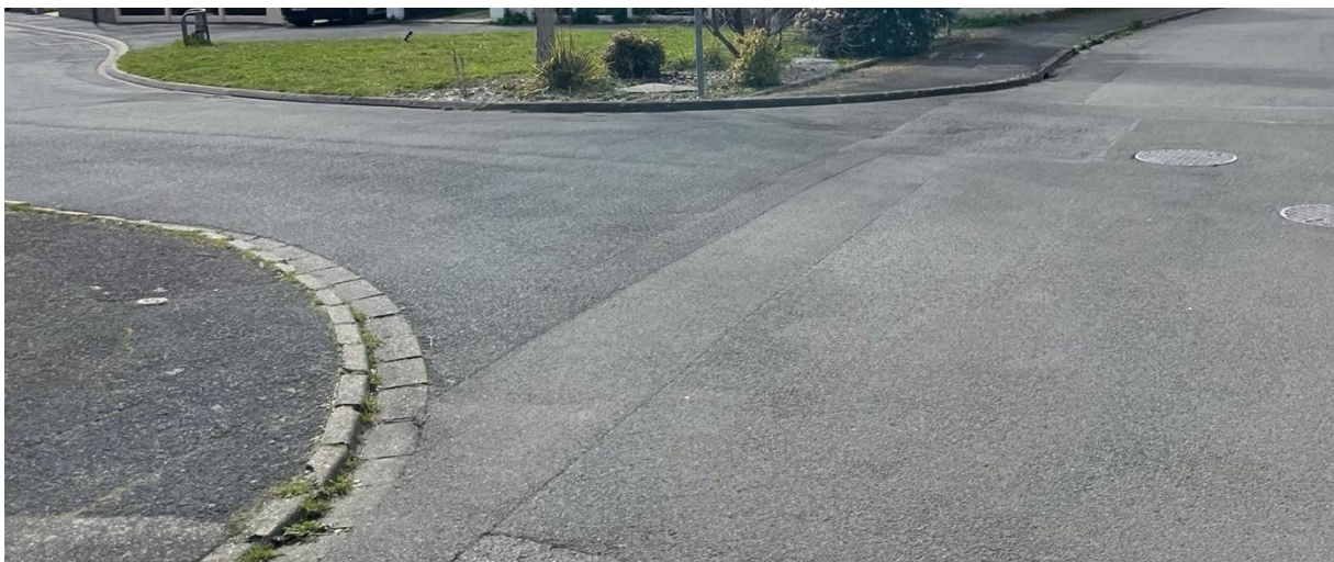
10 : ABSENCE DE PASSAGE PIETON ET TROTTOIR PAS ADAPTE
