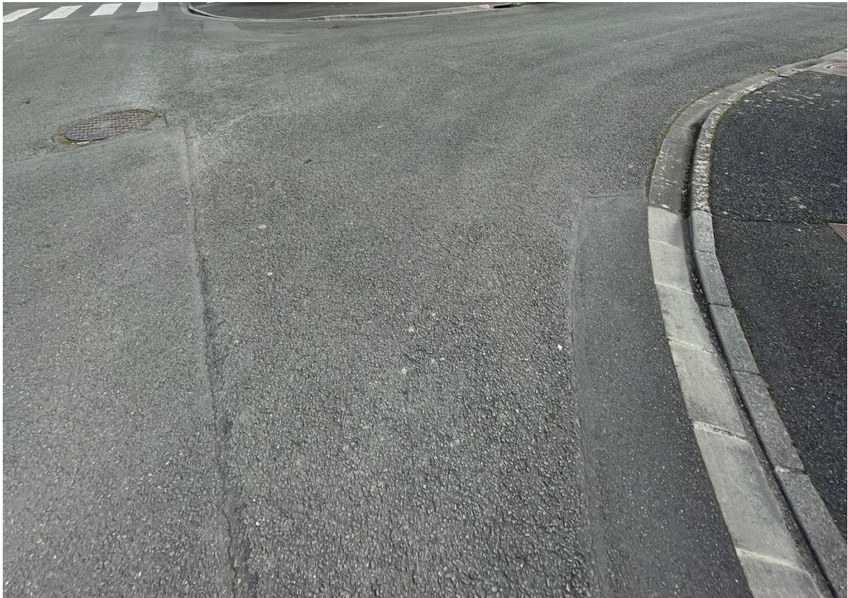
9 : ABSENCE DE PASSAGE PIETON ET TROTTOIR PAS ADAPTE
