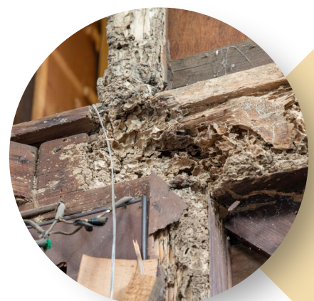
Attaque sur une charpente
